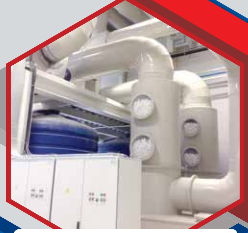
Gaz arıtma sistemleri Scrubber Scrubber
