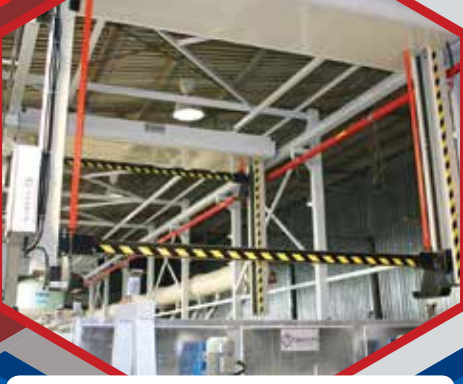
Alkali çinko tesisi, Eskişehir Alkaline - zinc facility, Eskisehir Impianto alcalino - zinco, Eskişehir
