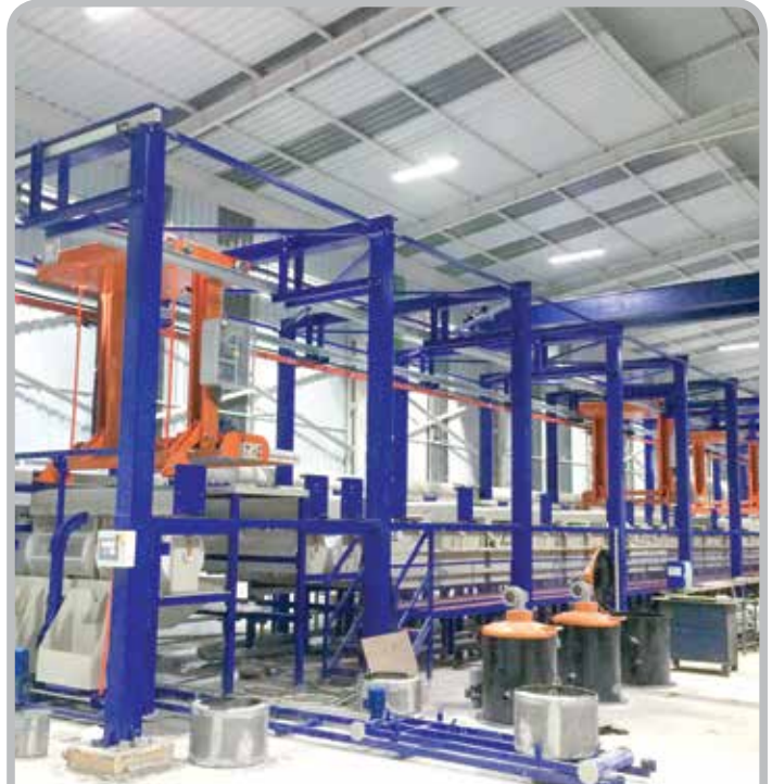
Tam otomatik asitli çinko kaplama tesisi, Mersin Türkiye Automatic barrel unit acid zinc plating facility, Mersin Turkey Impianto di zinco acido, Mersin Turchia
